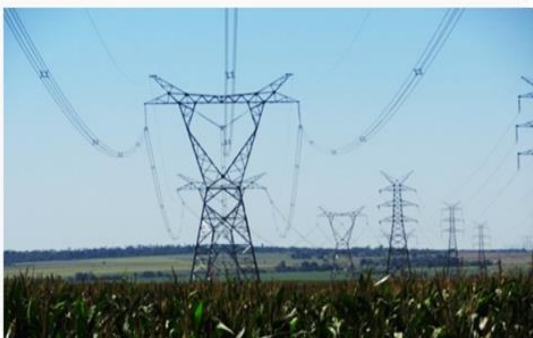
Figura 3. Siluetas de torres de 500 kV
